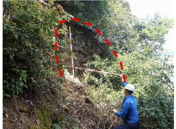
NO. 10～NO. 11 付近。奥行 1.5m 程度の岩盤の抜け落ちが確認された。
