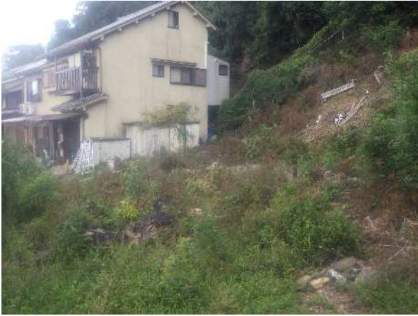
NO. 12 付近。10m 越の直立した岩盤斜面が人家と近接している。
