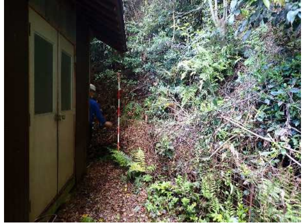
NO. 32 付近。高さ 5m 超の急崖が人家と近接している。
