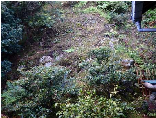
NO. 61 付近。高さ 5m 超の急崖が人家と近接している。
