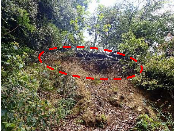
NO. 9～NO. 10 付近。厚さ 0.5m 程度の表土がオーバーハング状を呈している。
