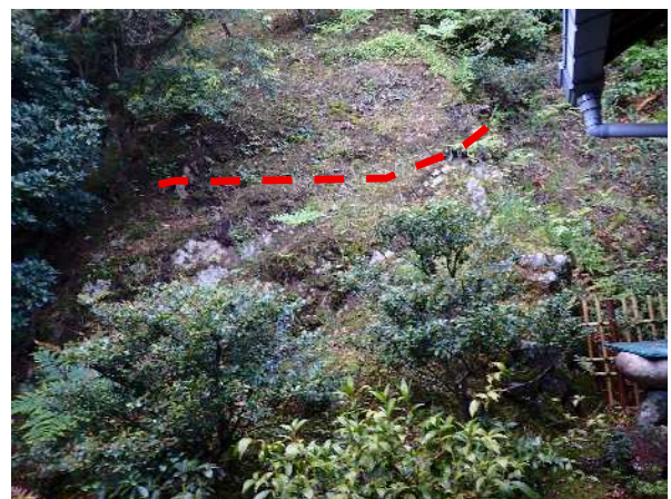
NO. 61～NO. 62 付近。岩盤の上に土砂が厚く堆積している。
