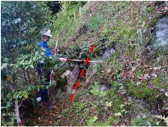
NO. 60～NO. 61 付近。岩盤に開口亀裂が確認された。亀裂の間隔は約 1m。
