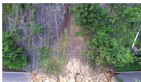
写真-4 国道163号落石・崩土
