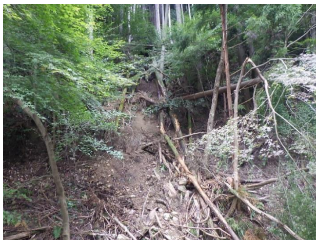
【写真：堰堤右岸部分小崩壊状況】
