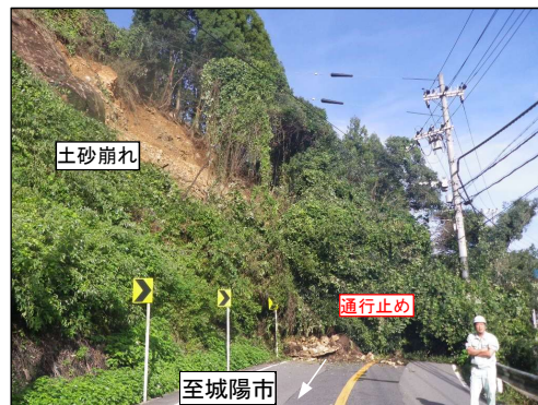
写真-3 被災の様子 (平成 25 年 9 月)
