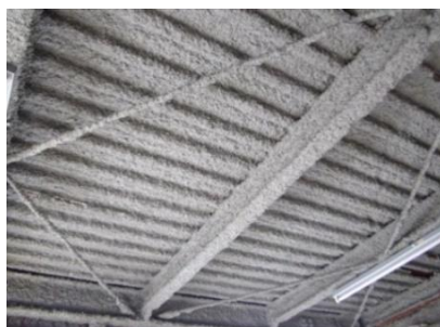
アスベスト含有建材の例
