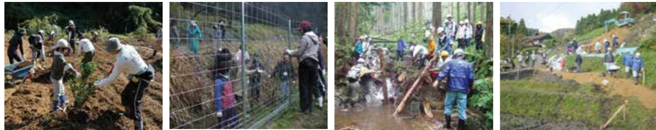
ゆず苗木の植栽(舞鶴市長谷) 鳥獣害防護柵の設置(伊根町本庄) 流木の撤去作業(京丹波町仏主) 農道拡幅作業(宮津市上世屋)
