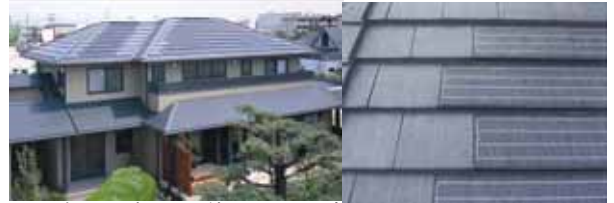
勾配屋根と一体となった太陽光パネル設置例
