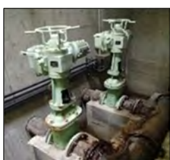
沈殿池設備(宇治)
