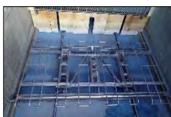
沈殿池設備(木津)
