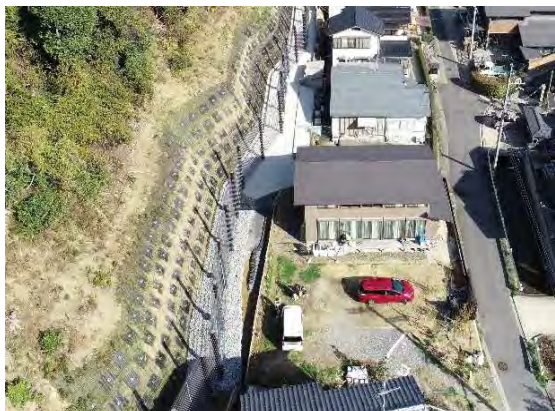
松室（京都市西京区） 土砂防護柵
