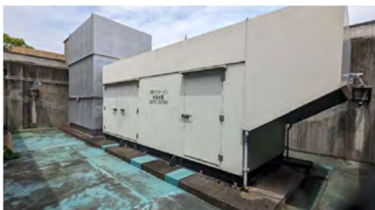
非常用発電設備（増設）
