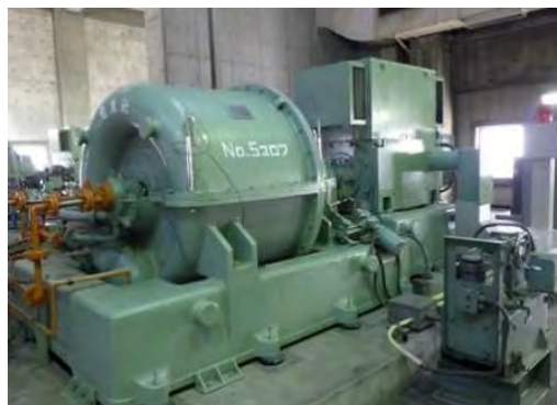
送風機設備（更新）
