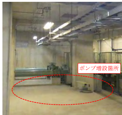
中継ポンプ場ポンプ増設箇所
