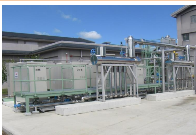
消化ガス発電(洛南、木津川上流) 洛南:センター消費電力量の約35% 木津川上流:センター消費電力量の約10%
