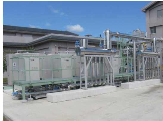
木津川上流流域下水道木津川上流浄化センター
