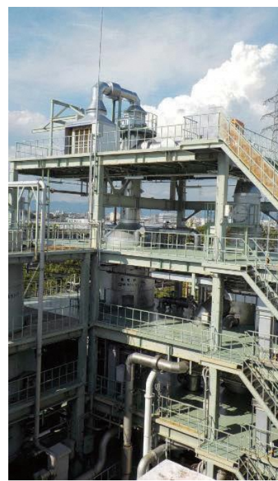
3号焼却炉本体
