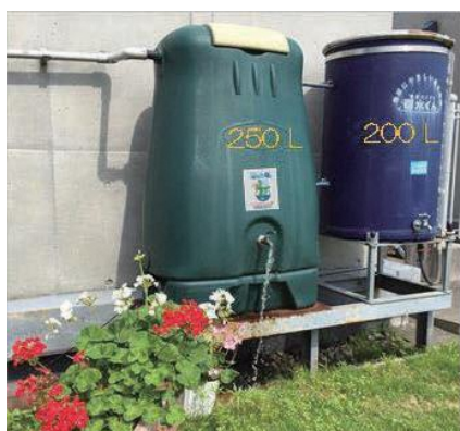
雨水貯留施設（府庁2号館屋上）
