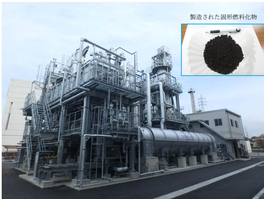
下水汚泥固形燃料化施設
