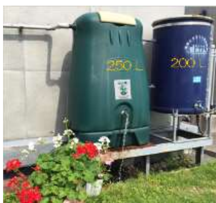
雨水貯留施設（府庁 2 号館屋上）
