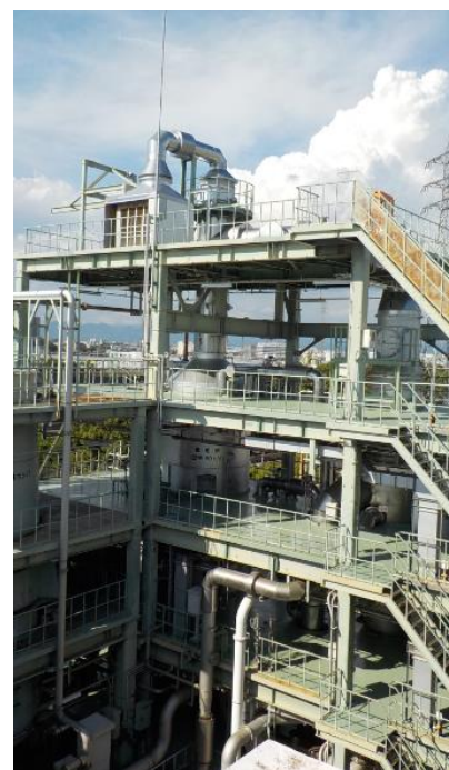
3号焼却炉本体
