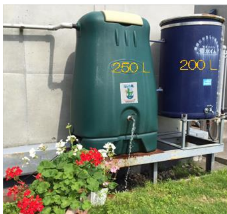
雨水貯留施設（府庁 2 号館屋上）
