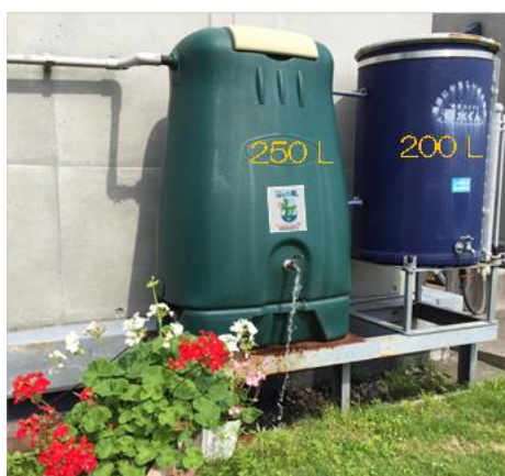
雨水貯留施設（府庁 2 号館屋上）
