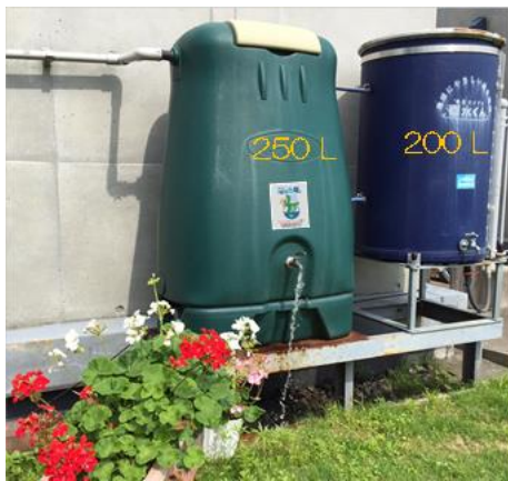
雨水貯留施設（府庁 2 号館屋上）
