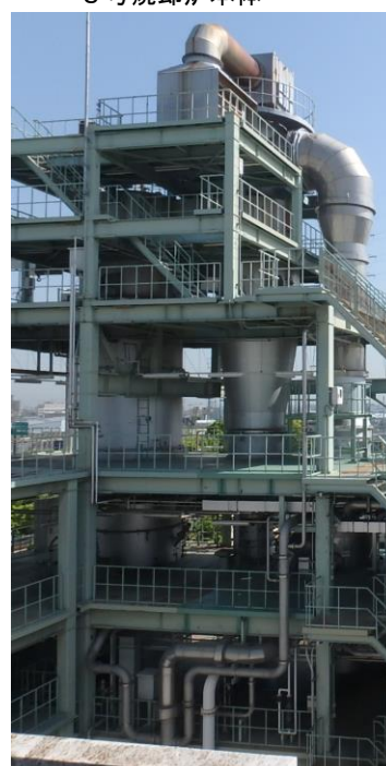
3号焼却炉本体
