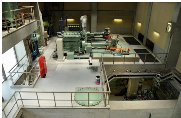
大山崎町 下植野排水ポンプ場内部
