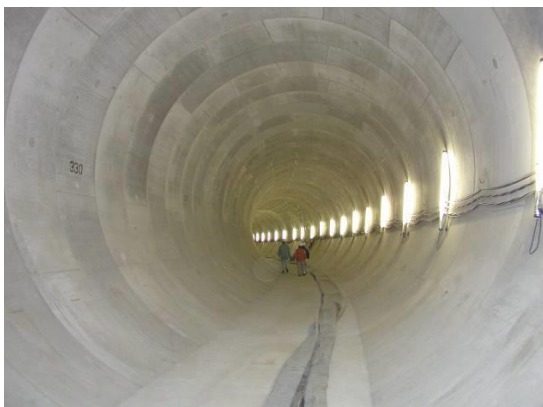
いろは香龍（どんりゅう）トンネル北幹線第3号管渠
