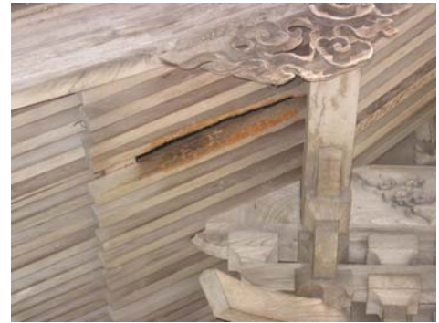
アライグマの屋根裏への侵入痕跡
