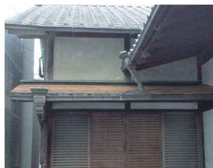
写真2 国登録文化財・楽々荘（亀岡市） 玄関庇（こけら葺）の葺替修理
