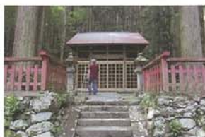
写真⑪ 八幡神社・本殿(南丹市) (未指定文化財・覆屋修理)
