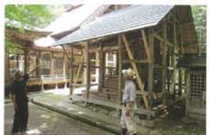
写真⑬ 阿須々岐神社・大川神社(綾部市) (府登録文化財・覆屋屋根修理)
