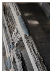
〈修理前の欄干〉
