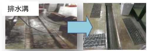
施設の衛生管理の強化に対応する排水溝、床、壁等の改修
