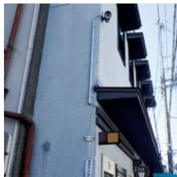
防犯カメラの設置
