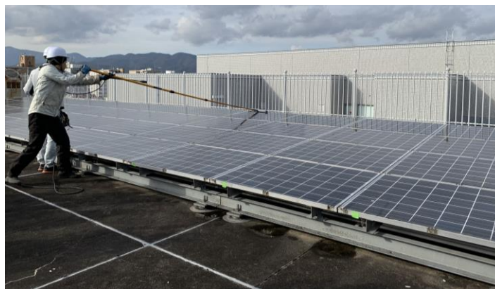
図3 京都府本庁舎2号館屋上における太陽光パネル
