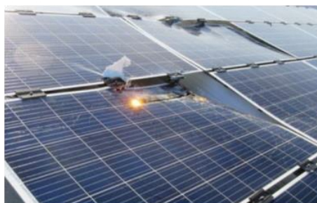
台風により破損したパネルの発火
