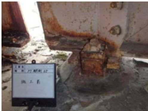
支承劣化状況
