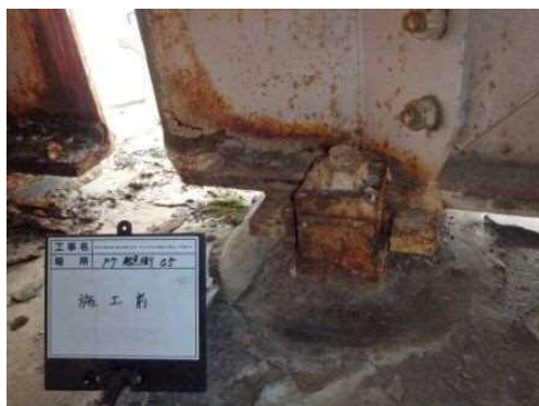
支承劣化状況
