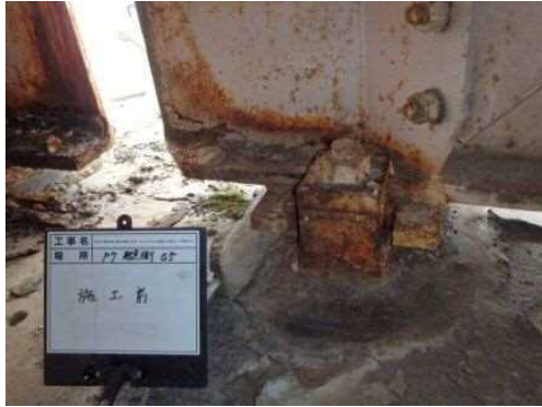
支承劣化状況
