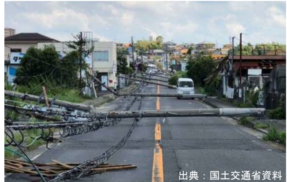
平成 30 年台風第 21 号による 電柱倒壊（大阪府泉南市）
