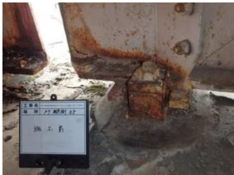
支承劣化状況
