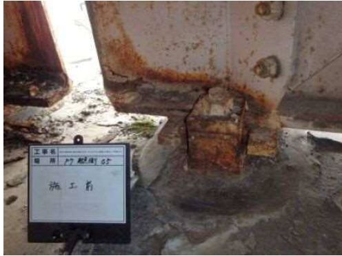
支承劣化状況
