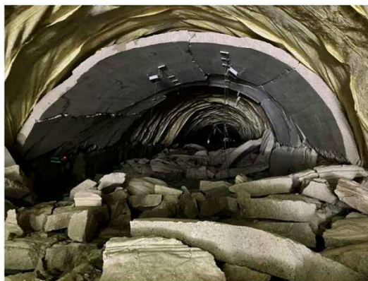
覆工コンクリート崩落(大谷トンネル)
