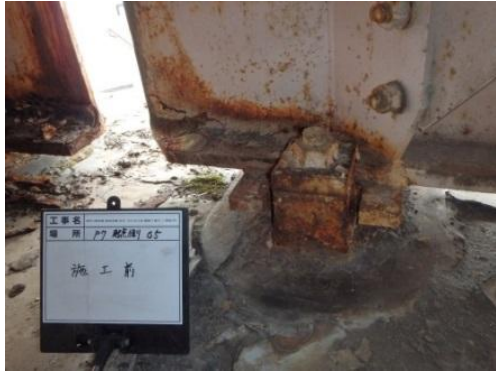
支承劣化状況
