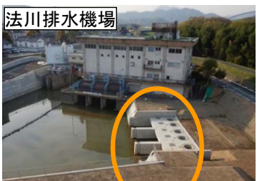
ポンプ・発電機棟の工事を実施(緊急排水ポンプ12.0m 3 /s)
