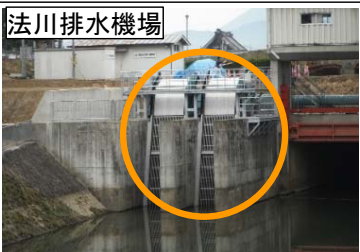
緊急排水ポンプ(3.0m 3 /s)増強ポンプ完成(H29.3)
