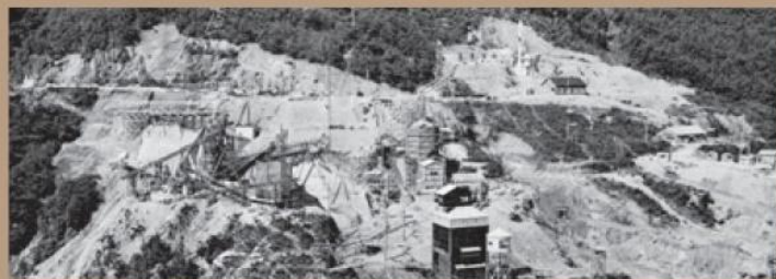
仮設備工事が着々と進むダムサイト右岸台地 昭和33年9月末
