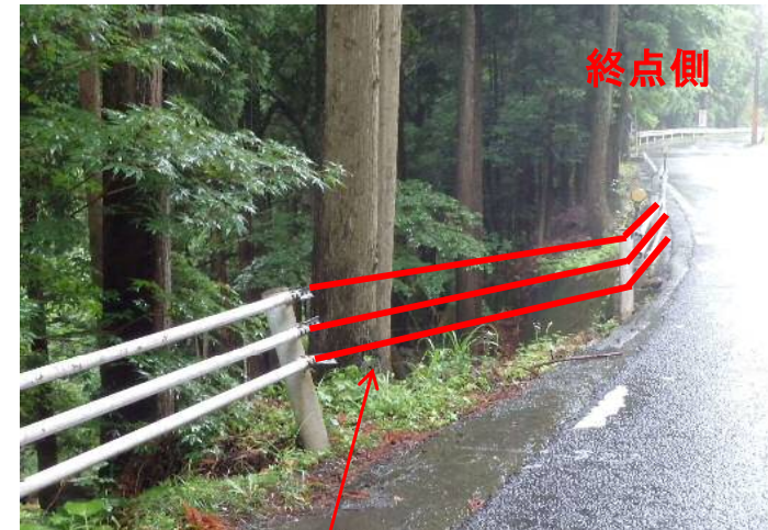
老朽化・破損箇所
