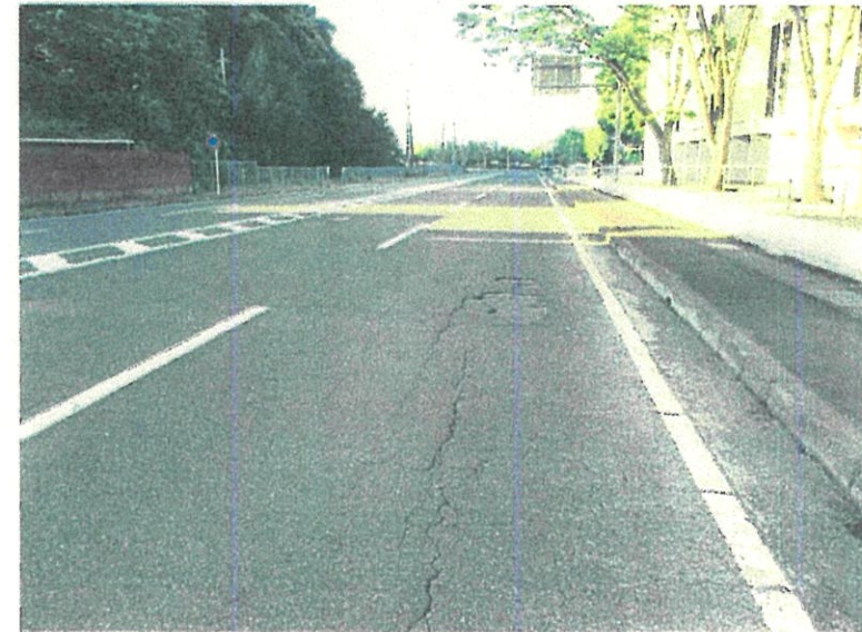
舗装剥離、亀裂状況
