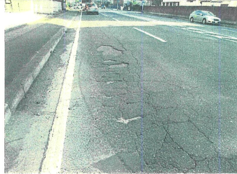
舗装剥離、亀裂状況
