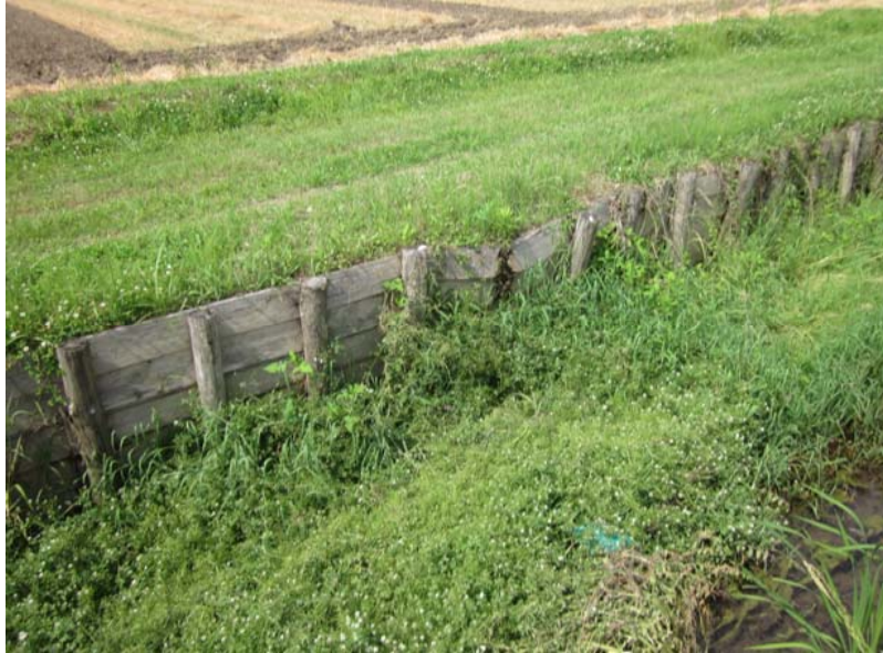
板柵の老朽化および破損
