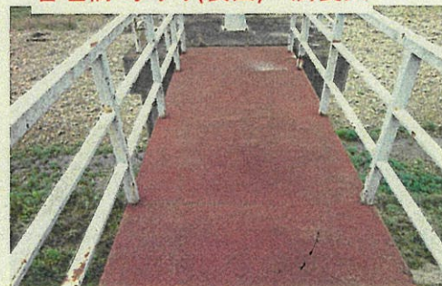
管理橋・手すり(表面)－腐食大
