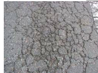
舗装損傷局部
