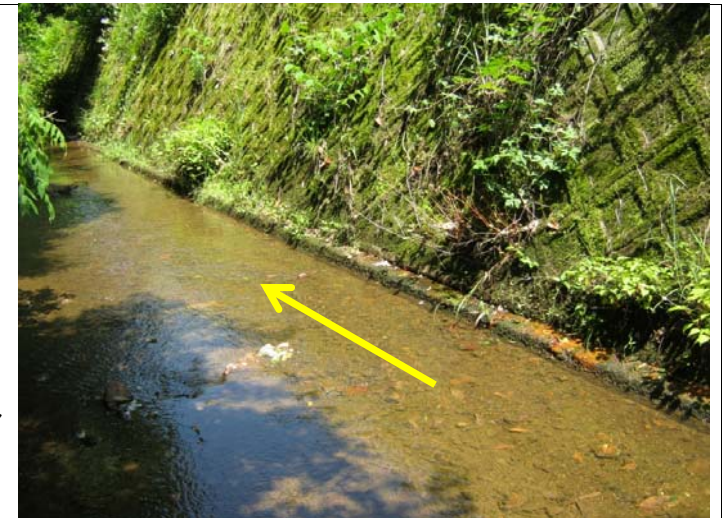
基礎根入れ 不足箇所
