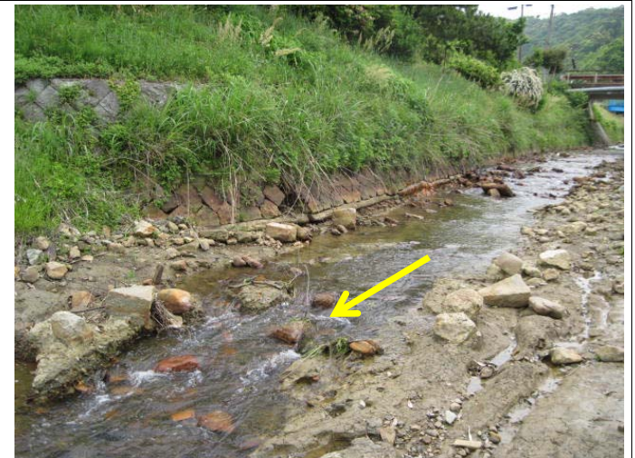
河床低下区間
