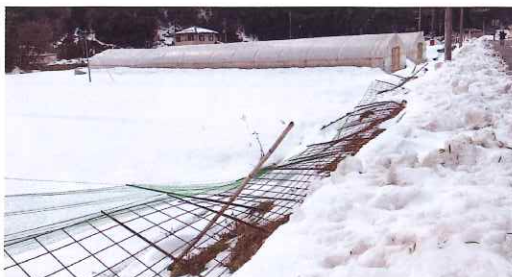
積雪によりなぎ倒された防護柵
