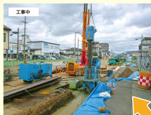
出水時に流木等が堆積した弘法川の橋を大きな橋に架け替えています。
