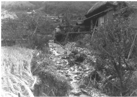
山谷川の被災状況
