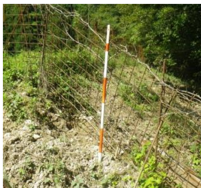
柵の勾配が変化する場所で潜り込み
