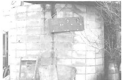
このサイロ内に処理槽が収納されています
