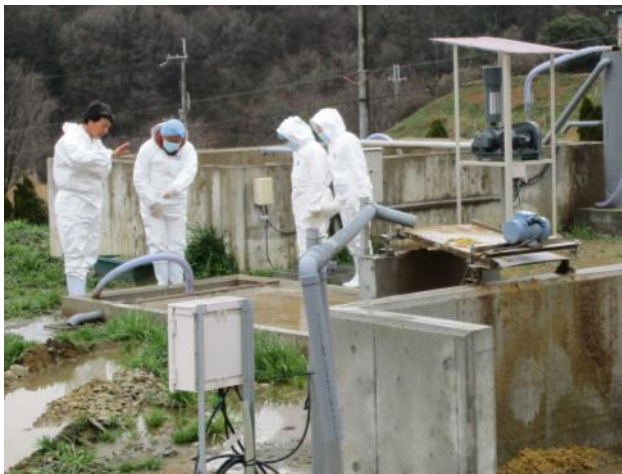
設置した酪農家の污水处理施設
