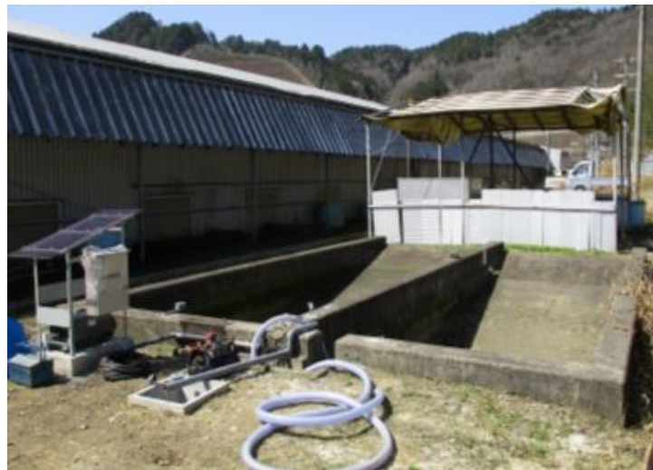
新設した洗卵排水処理施設
