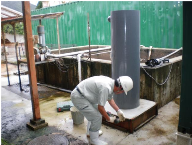
新たに設置した汚泥濃縮装置
