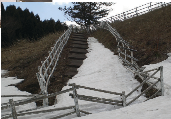
大きく傾いた展望台遊歩道の牧柵
