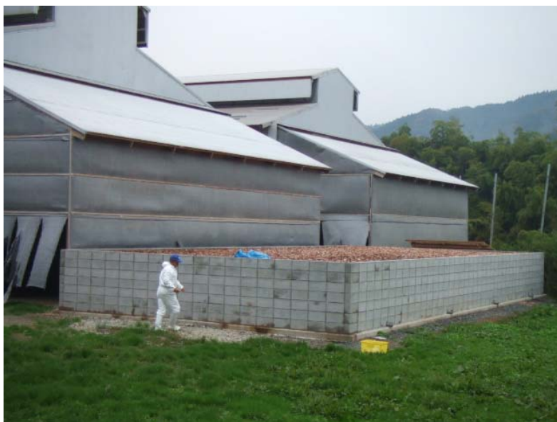
完成した脱臭槽
