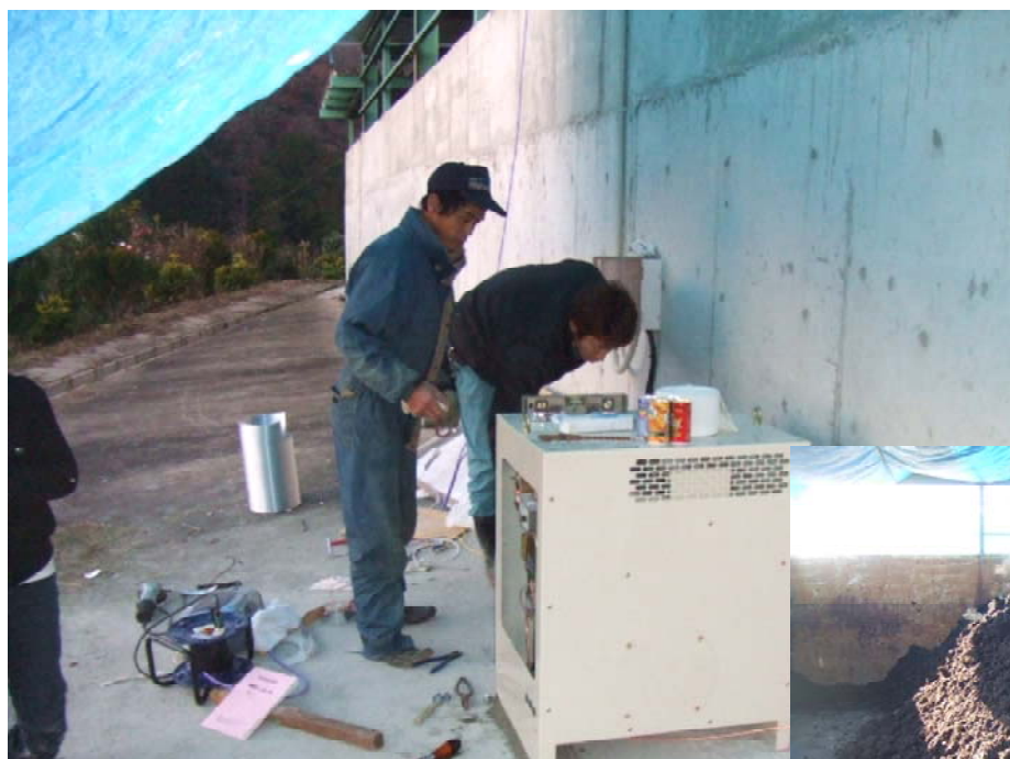
農家による温風器設置状況
